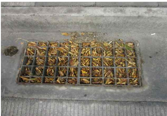
배수시설 SPAN.7 집수구 이물질퇴적
