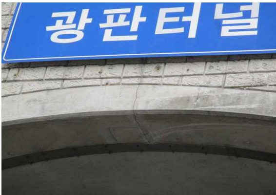
시점부 면벽 균열(0.3mm 이상)
