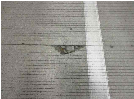
포장부 SPAN.5 파손
