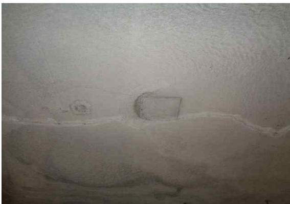
라이닝 SPAN.26 균열(0.3mm이상)
