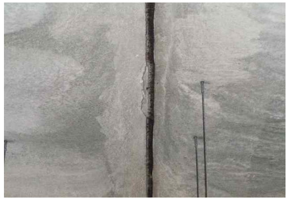
라이닝 SPAN.22 조인트부 박리
