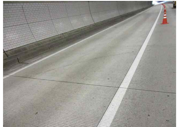
포장부 SPAN.9 균열(0.3mm 이상)
