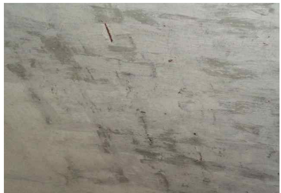
라이닝 SPAN.39 와이어매쉬 노출
