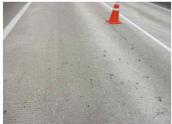
포장부 SPAN.18 포장열화
