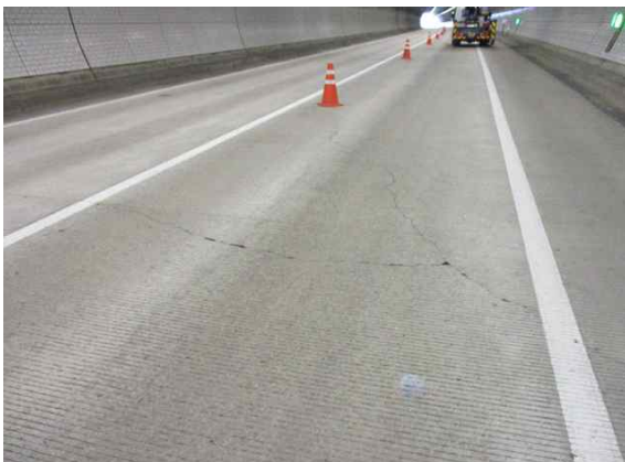
포장부 SPAN.9 균열(0.3mm 이상)
