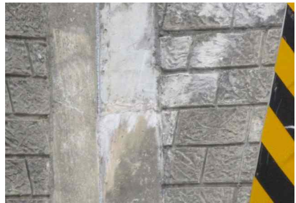
시점부 면벽 균열부 백태
