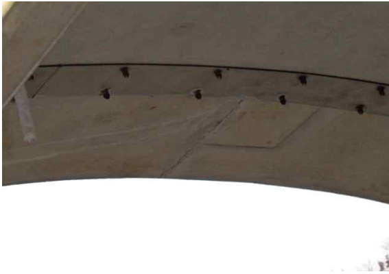
라이닝 SPAN.1 균열(0.3mm이상)
