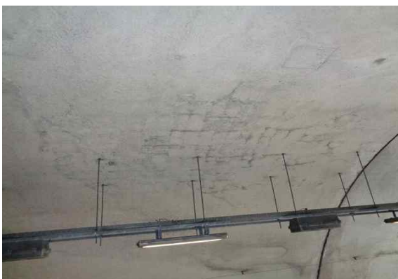
라이닝 SPAN.40 와이어매쉬 노출
