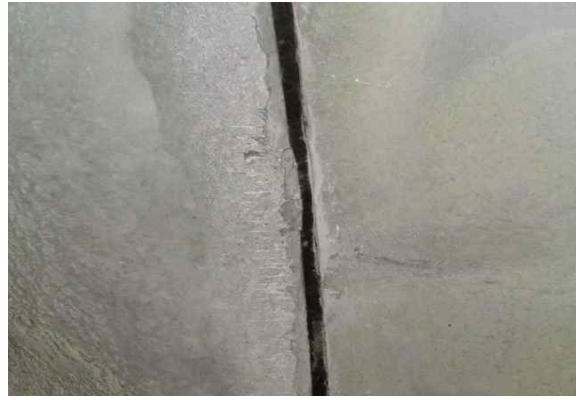
라이닝 SPAN.5 조인트부 박리
