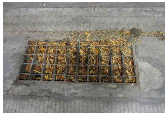
배수시설 SPAN.17 집수구 이물질퇴적
