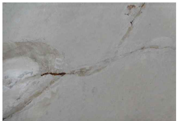
라이닝 SPAN.41 균열(0.3mm이상)
