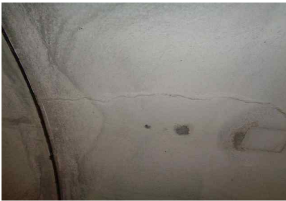
라이닝 SPAN.18 균열(0.3mm이상)
